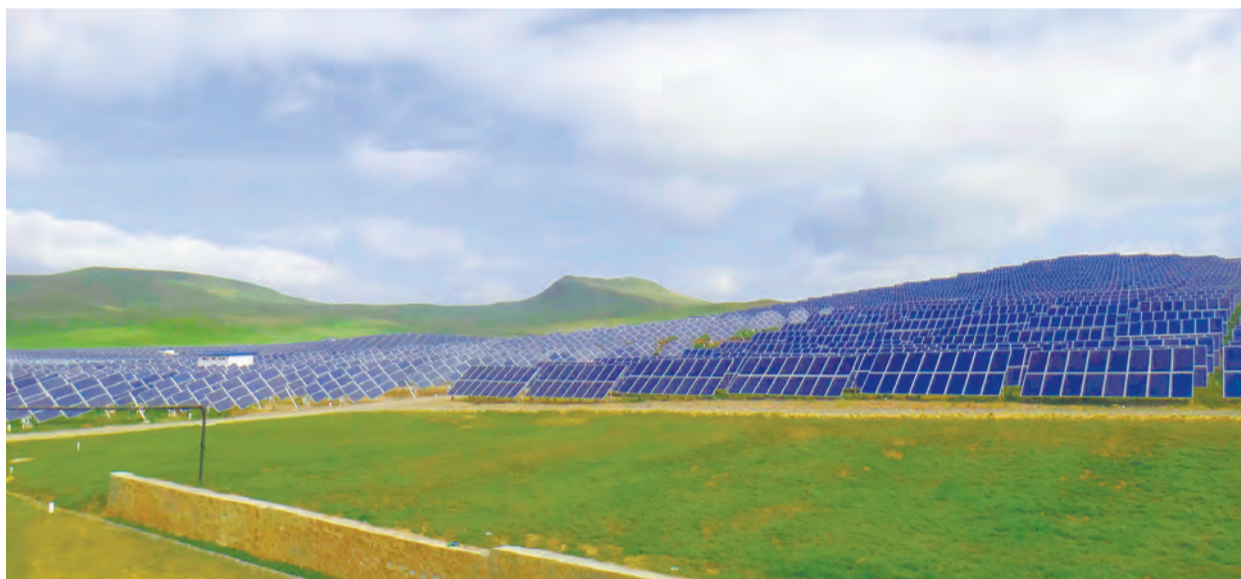
近日,河南县总投资4056万元,占地约14公顷,装机容量5.3兆瓦,覆盖16个建档立卡贫困村、770户贫困户、2939人的村级光伏扶贫电站建设项目并网投产。该项目是全省首个建成并网投产的光伏扶贫电站。项目投产后,每年收益约556万元,能为16个贫困村每村带来约35万元的村集体经济收入。同时每年可节约标煤约2376吨,减少温室气体二氧化碳约6342吨,减少大气污染物二氧化硫48吨、氮氧化物16.36吨。 河南县政府 供
