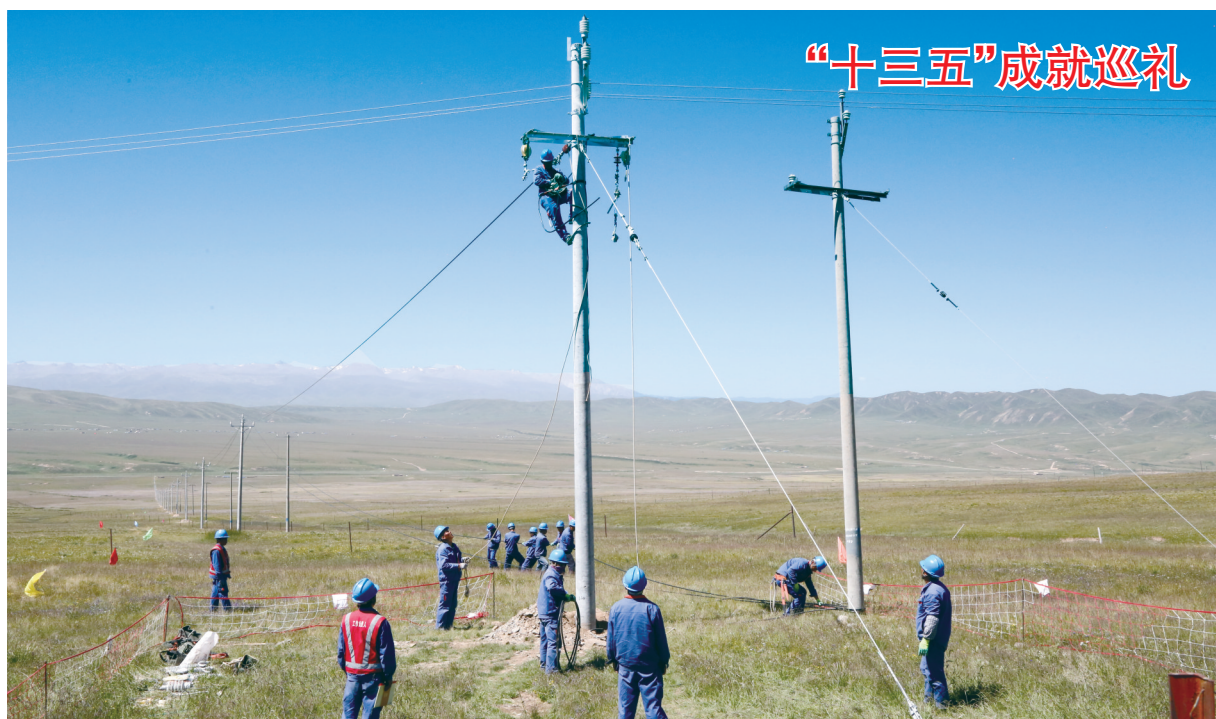
近年来,黄南州扎实作为,加快推进电力行业扶贫脱贫工程。自2016年以来,累计投资11.28亿元,实施建档立卡贫困村电网改造项目68个、易地搬迁电网配套项目42个、深度贫困地区电网改造项目66个、“三区三州”电网建设项目96个,完成105个贫困村电网改造升级,解决4739户易地搬迁群众用电问题,惠及11.6万人,贫困地区群众实现了从“用上电”到“用好电”的转变。图为国网黄化供电公司在尖扎滩实施农网改造工程。
