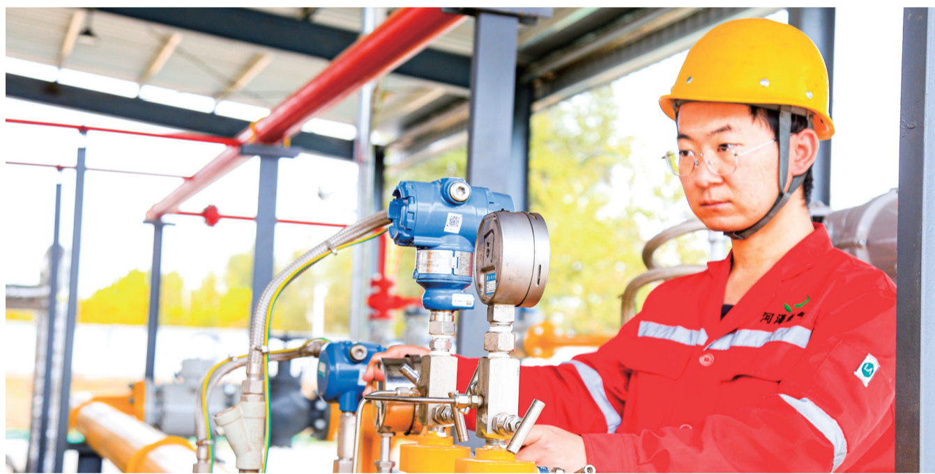
10月11日,总投资5800万元的同仁市天然气利用工程市政管网(一期)建设项目正式开阀通气。该项目起点为向阳村门气站,终点为唯哇三岔口,铺设管道24.8公里。据记者走访了解,州府主城区1-5期主要集中供热站已成功接入天然气管网,各站点均处于燃气供热设备调试阶段,有望于15日正式实现城区天然气供暖全覆盖。10月13日,黄南州天然气利用工程举行通气点火仪式举行。 记者 张海麟 摄
