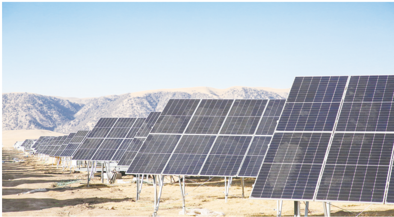
同仁市“牧光储”多能互补综合一体化光伏项目位于瓜什则乡郭进村,项目规划装机容量200MW,用地总规模4403亩,总投资约11.11亿元。预计该项目在12月底建成投产,投产后将产生良好的经济和生态效益,对助力黄南州新能源转型,加快实现“碳达峰、碳中和”目标,构建新型电力系统具有重要意义。 记者 关却才 摄
